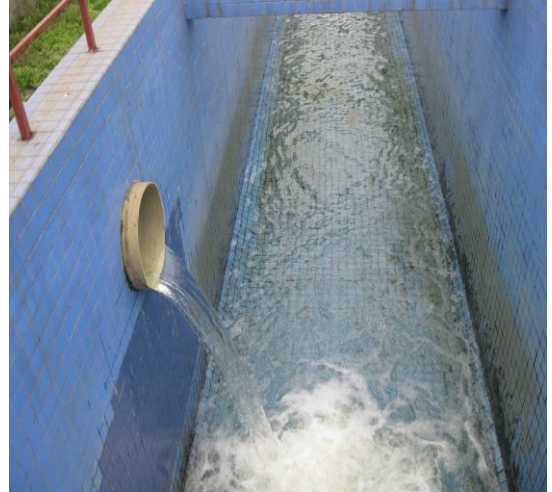
Hình 1.13. Hệ thống thu nước sau bãi thấm lọc
