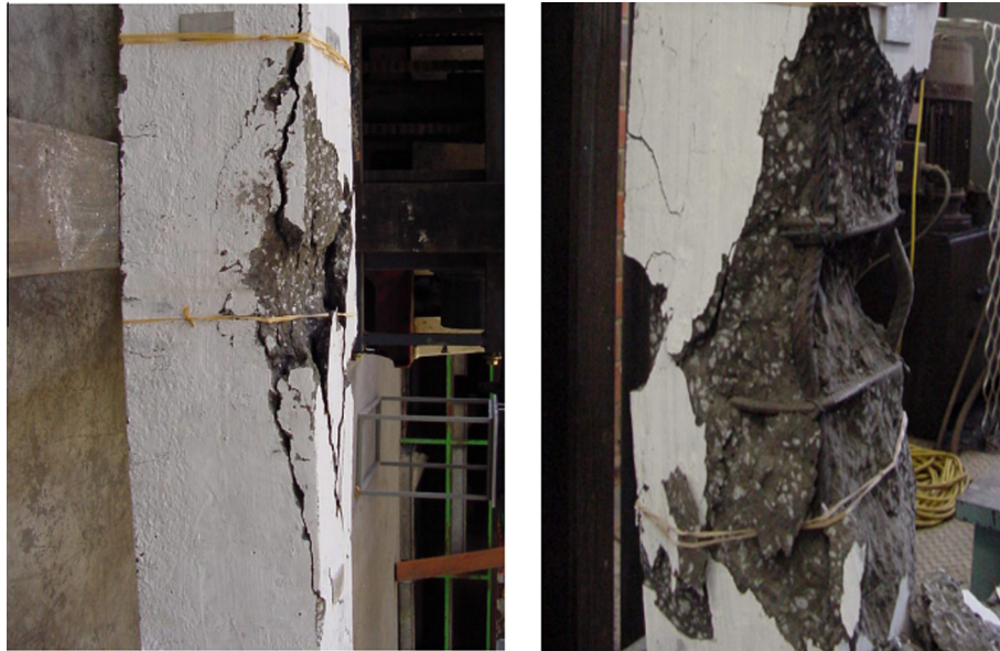
Fig. 6. Failure mode of slender geopolymer concrete columns [28].
